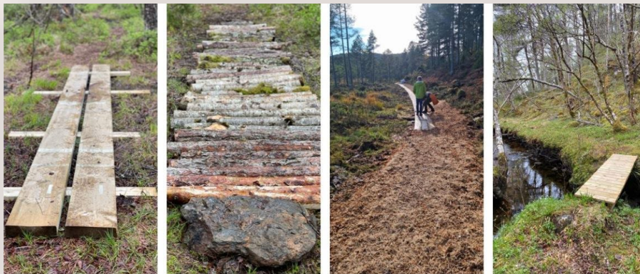
Frå venstre: enkel klopp, kavlesti ved bruk av rundstokkar (frå nærliggande skog), bruk av fliskutt (frå nærliggande skog) og enkel kloppebru
