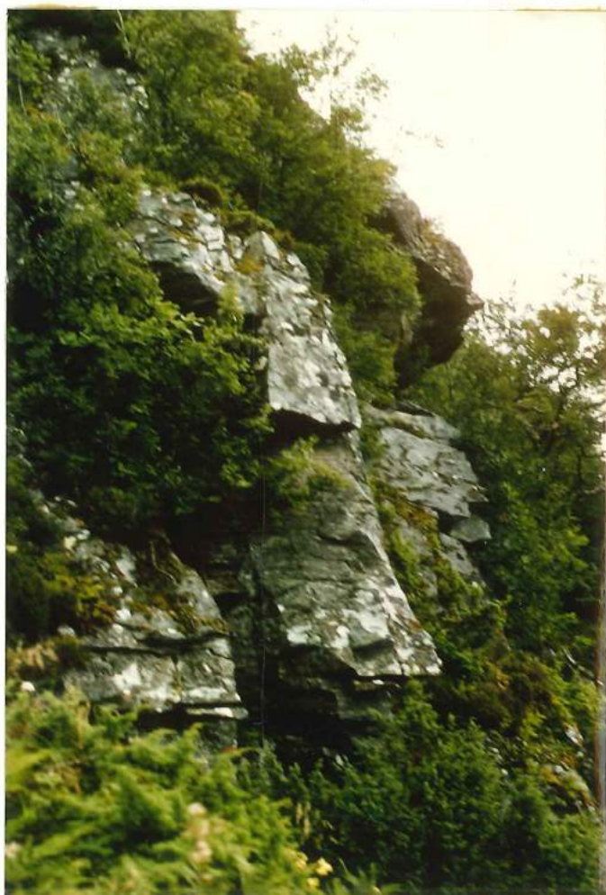
Foto nr.6. Skredfarlig parti overfor Kvitnesvegen nær profil 12, tegn.001. Hammeren oppe til høyre hadde svært dårlig fot.
